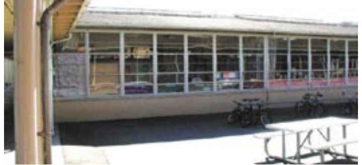
Ala de la escuela Live Oak School construida hace 50 años: Necesita un techo nuevo, nuevas cañerías, y modificaciones para aumentar la eficiencia de las instalaciones eléctricas y de energía.
